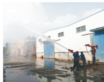
电动消防水炮
