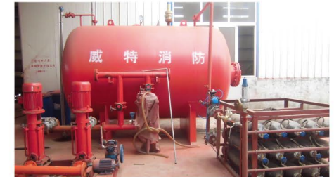
消防气体顶压装置
