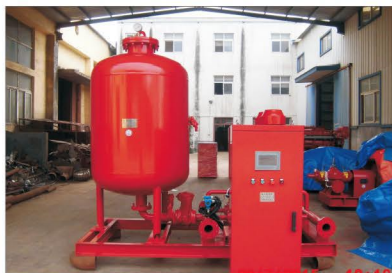
消防稳压装置
