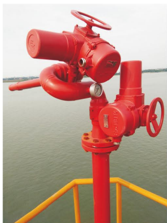
电动消防水炮
