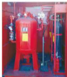
单储罐干粉灭火装置
