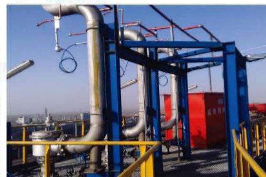
内蒙古中石油LNG干粉灭火装置
