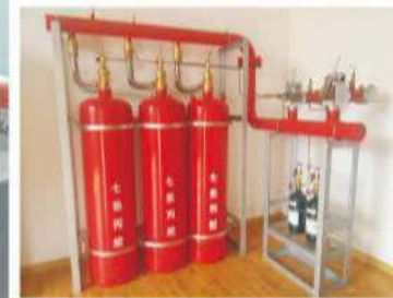
七氟丙烷气体灭火系统
