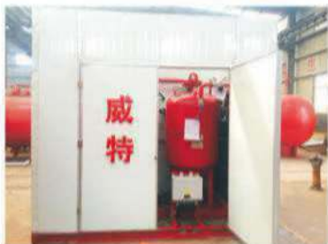
双储罐（一用一备）干粉灭火装置
