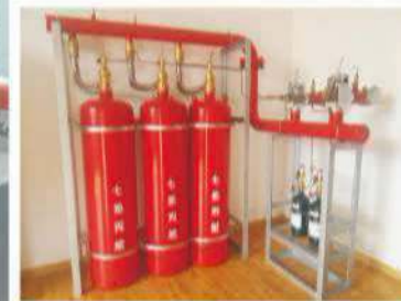
七氟丙烷气体灭火系统
