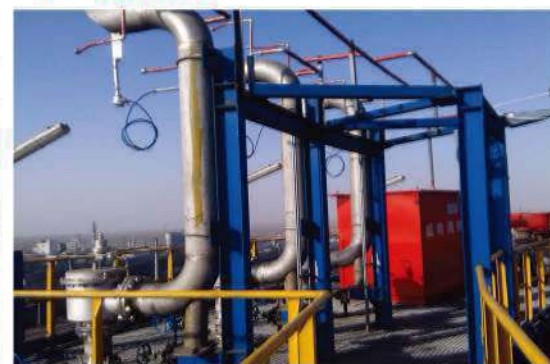
内蒙古中石油LNG干粉灭火装置
